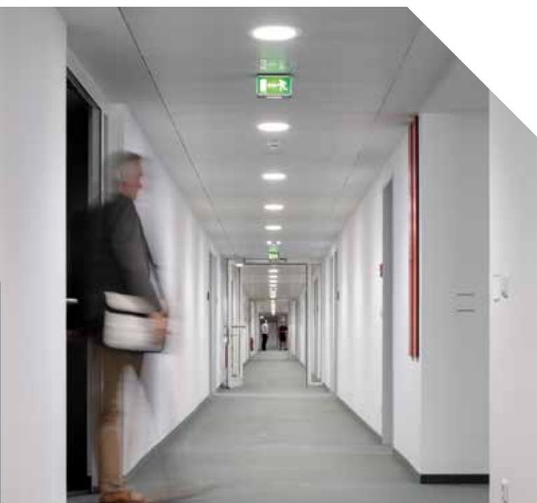
Die Flurbereiche wurden mit energieeffizienten Deckeneinbauleuchten CETUS der Zumtobel Group Marke THORN ausgestattet.
