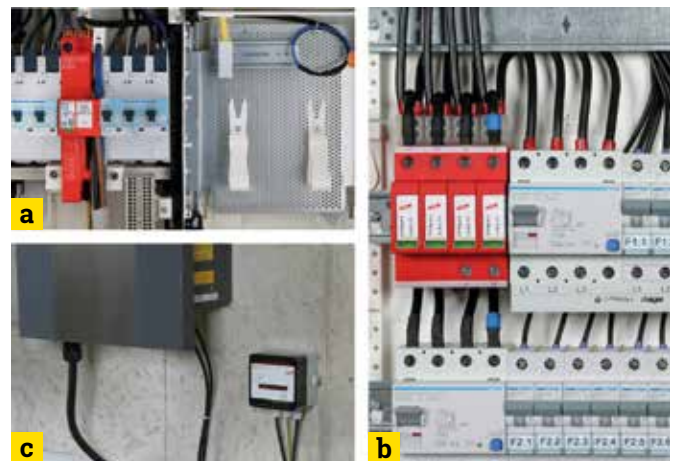
Bild 1: a) Anwendung DEHNshield ZP B2 SG im Zählerplatz; b) Überspannungsschutzgerät SPD Typ 2 DEHNguard M TNS 275 zum Schutz der AC-Seite des Wechselrichters; c) Überspannungsschutzgerät SPD Typ 2 DEHNCube YPV SCI 1000 zum Schutz der DC-Seite des Wechselrichters
